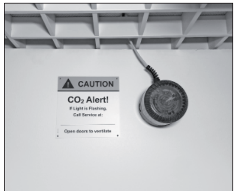
Varningslampan med skylt
