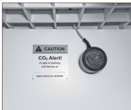
Varningslampan med skylt
